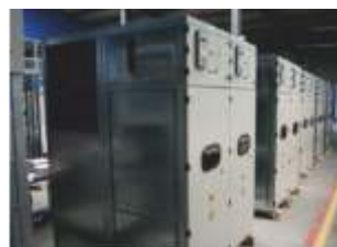
Echipament electric medie tensiune Stația electrică 12 kV. CET Dalkia Petrobrazi - România.
